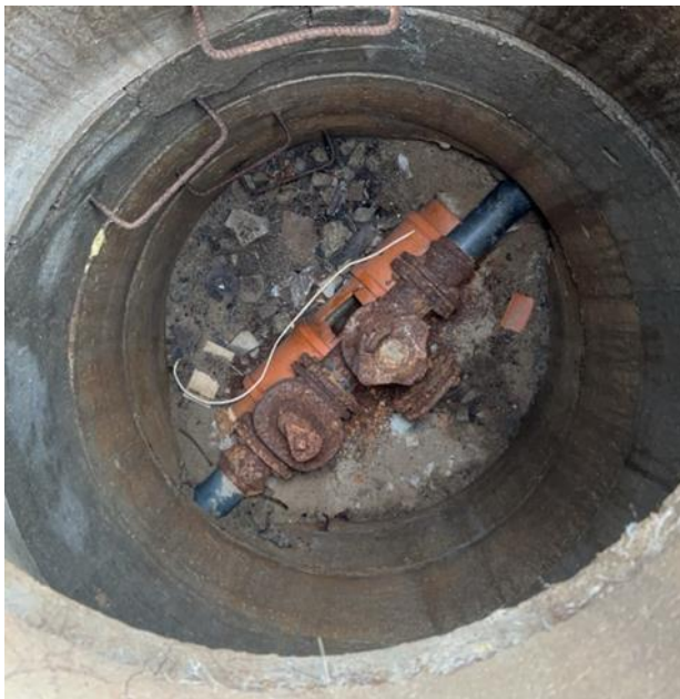
Vann- og spillvanns-kum i Lismaveien med brannventil (privat, 2024)
